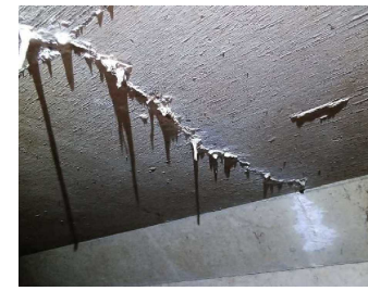
クラック（管頂部付近）
