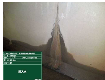
継手からの浸入水
