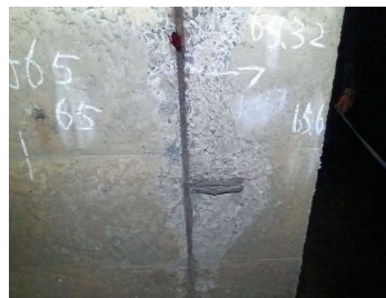
コンクリート剥離・鉄筋露出
