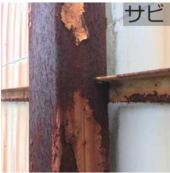
鉄骨やボルトのサビは、 破損の第一歩
