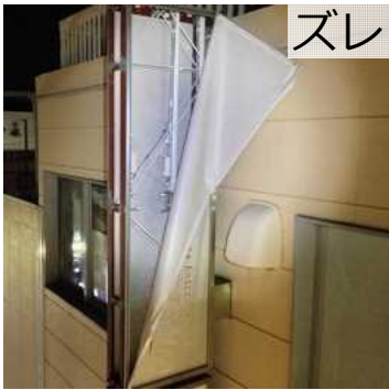
盤面のズレや取付具の 欠落は落下の前触れ
