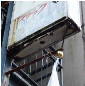
袖看板の底部脱落
