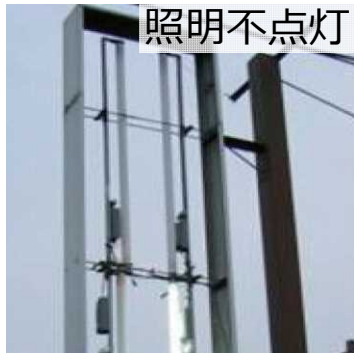
漏電している場合は、 火災の危険性も！
