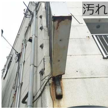
サビ汁がたれていたら、 内部が腐食しているかも？！
