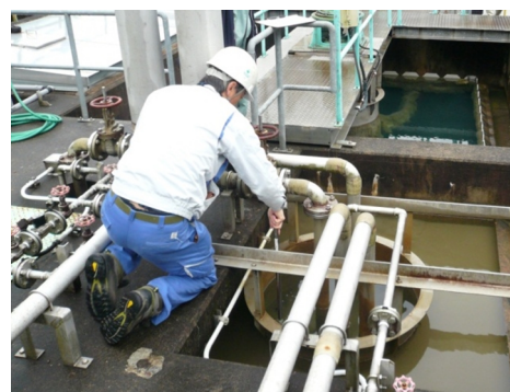
浸出水処理施設での水質検査
