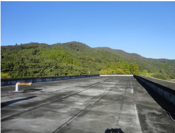
◆ 防水シートの浮きあり
