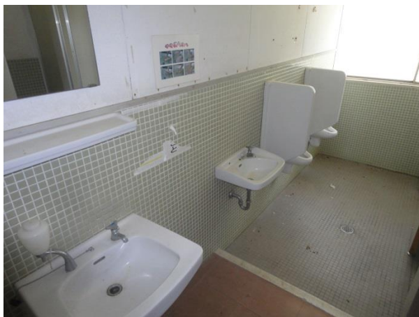
校舎 1 (トイレ) ※老朽化が進行
