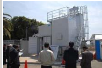
日向サンパーク温泉に導入された 木質バイオマスボイラー
