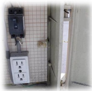
電源ボックス内
