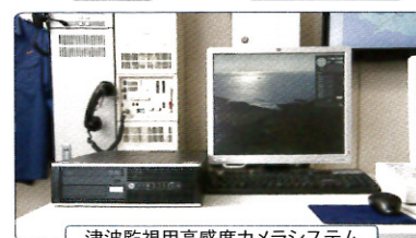
津波監視用高感度カメラシステム
