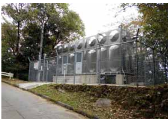
中継ポンプ所
