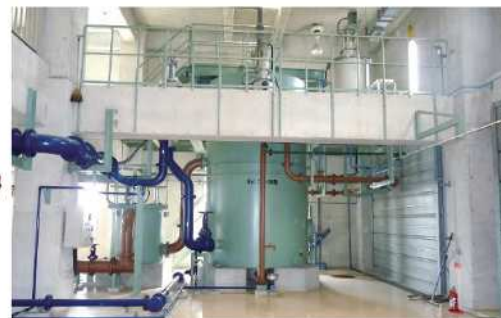
機械濃縮設備
