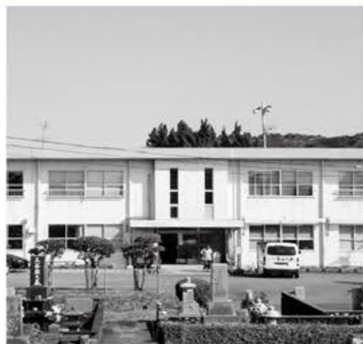
▲ 老朽化で改築等が望まれる美々津支所
