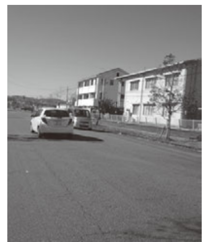
▲ 中央と外側の白線が消えた市道
