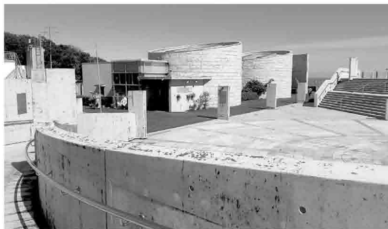
サンパーク温泉の階段に設置された手すり
